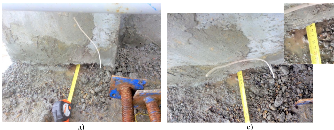
Рис. 2. Скрытые дефекты в платформенном стыке, выявленные при строительстве здания: а, б — перегиб вертикальной арматуры выше уровня плиты перекрытия, в, г— бетон рыхлой структуры в нижней части колонн, д, е — пустоты в уровне низа колонн глубиной до 150мм, шириной до 300мм (иллюстрация авторов)
