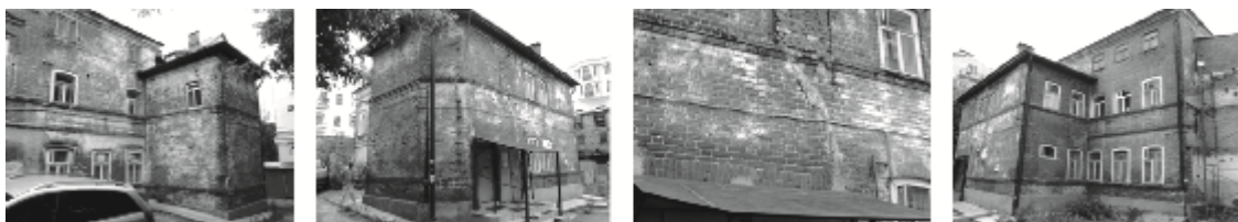
Рис. 6. Общий вид технического состояния конструкций наружных стен в зонах примыкания пристроев к основному корпусу жилого дома.
