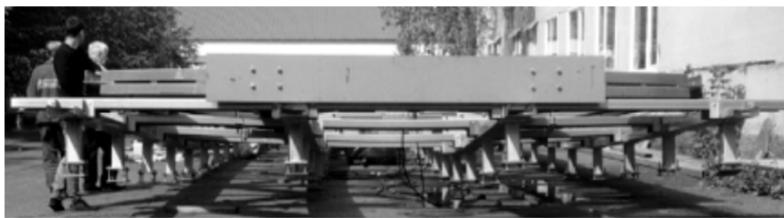
Рис. 6. Внезапное вертикальное перемещение из плоскости крайних узлов ферм и элементов стенда (ЗАО «Ариада, 2018 г.)
