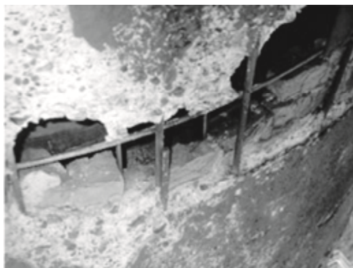
Рис. 1. Сквозные отверстия в стенке. Коррозия арматуры
