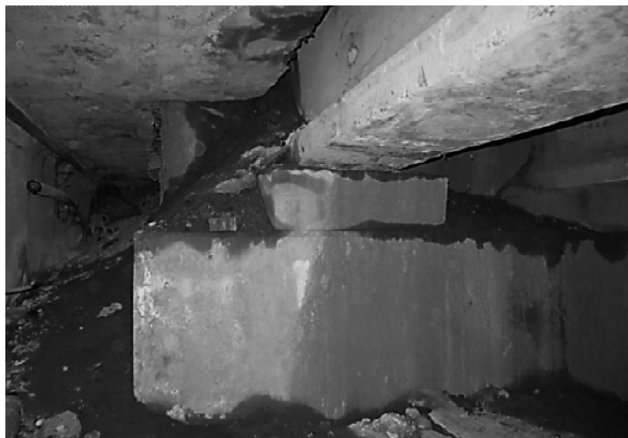
Рис. 1. Проникновение вод на опорные части мостового сооружения (иллюстрация авторов)
