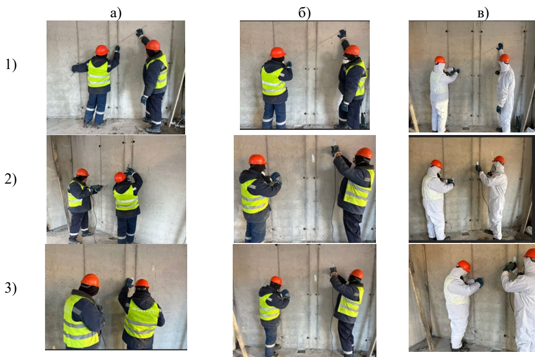
Рис. 4. Фотофиксация работ по структурному укреплению трещин в ж/б конструкциях поэтапно: 1-й ряд – в начале работы, 2-й – в процессе, 3-й – в конце работ в различных условиях производственной среды: а) в обычной; б) в вредной; в) опасной (иллюстрации автора)
