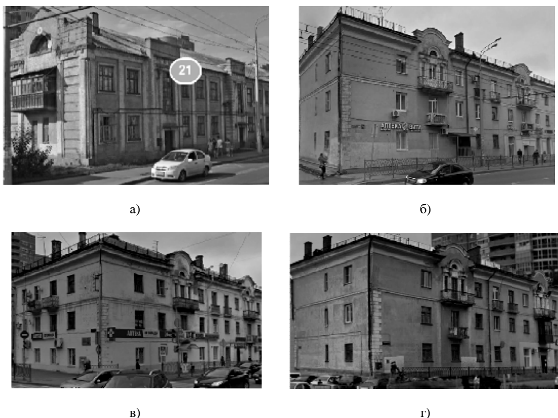
Рис. 10. Общий вид и техническое состояние объектов, возведенных в разные периоды и расположенных вдоль ул. Ленинградская, в Авиастроительном районе города Казани, рекомендуемых к передвижке при реновации участка городской среды (фото авторов):
