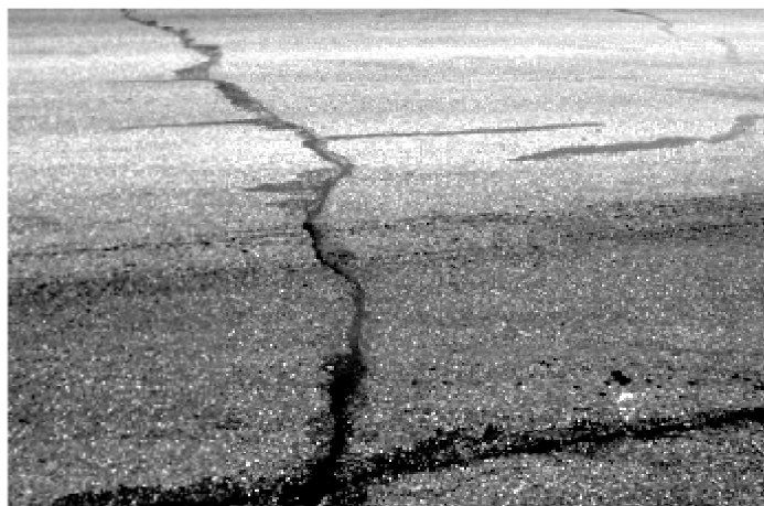
Рис. 3. Поперечные трещины на поверхности асфальтобетонного покрытия [5]
