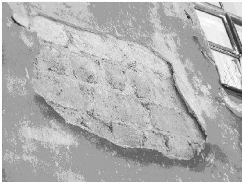
Рис. 8. Несмотря на постоянное отслоение наружной штукатурки наблюдается хорошее состояние гипсобетонных блоков (фото 2008 г.)
