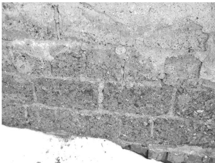
Рис. 9. Цокольная часть дома по ул. Нежинской. Несмотря на постоянное промораживание и воздействие атмосферной влаги за более чем 60 лет эксплуатации дефекты минимальны. Виден состав гипсобетонных блоков с заполнителем на основе топливных шлаков местных котельных
