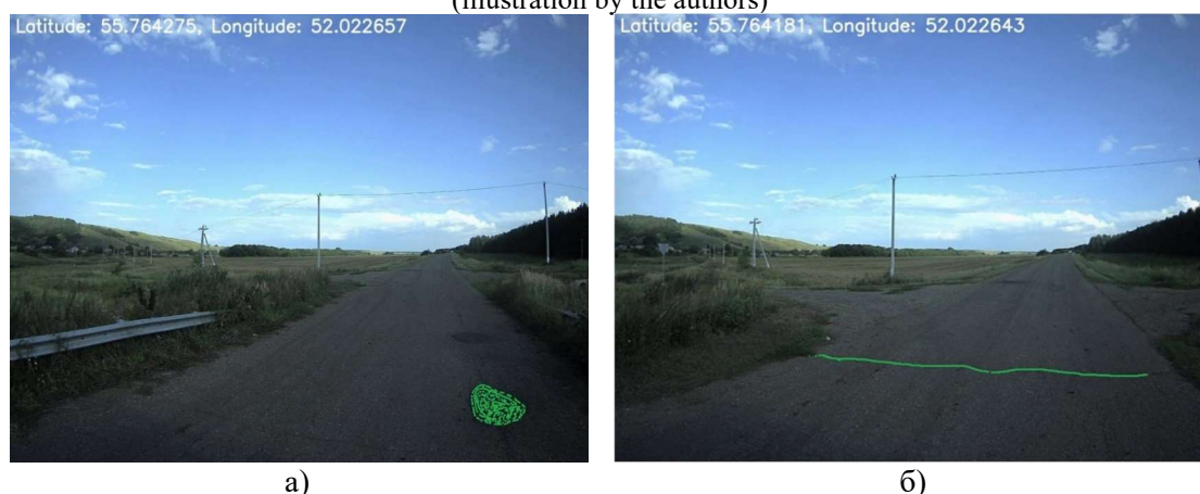
Рис. 5. Обнаружение дорожных дефектов при помощи модели компьютерного зрения: а) выбоина, б) трещина (иллюстрация авторов)
