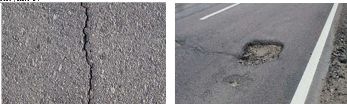
Рис. 3. Пример фотографий дорожных дефектов для обучения нейросети (иллюстрация авторов) Fig. 3. Example of photos of road defects for training a neural network (illustration by the authors)
