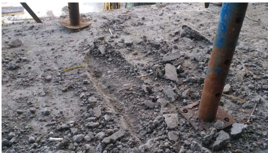
Рис.4 Вскрытый дефект в виде промораживания поверхности слоев «пузырь» в зоне консоли (иллюстрация авторов)
