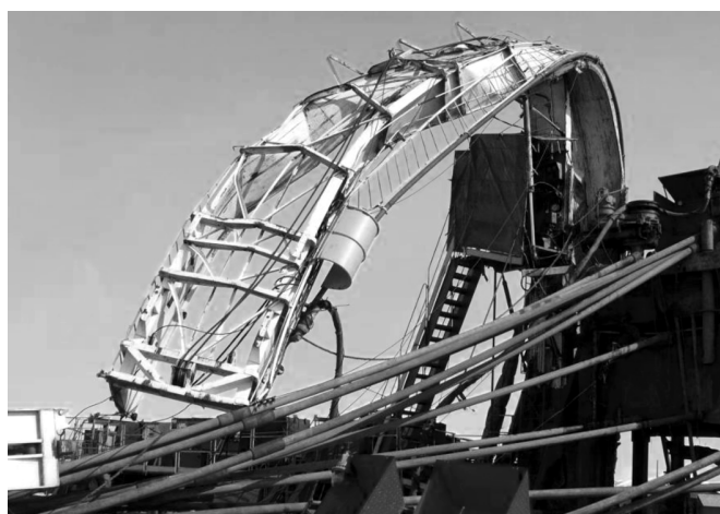
Рис. 4. Состояние элементов решетки верхнего конца нижней секции после разрушения
