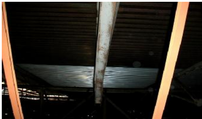
Рис. 4. Состояние профилированного настила, эксплуатирующегося в травильном отделении
