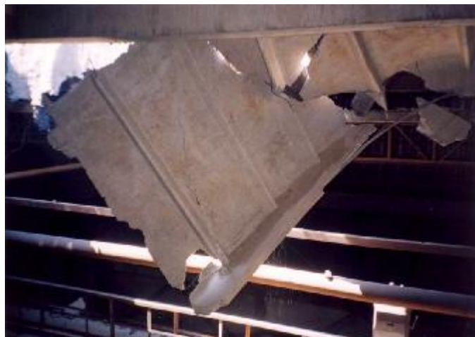
Рис. 5 Обрушение плиты покрытия
