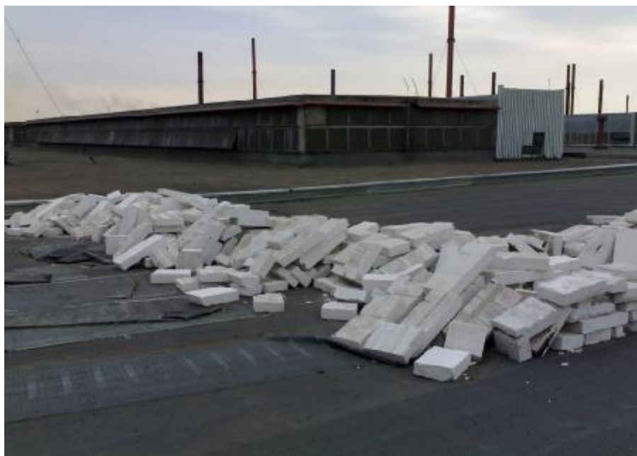
Рис. 1. Характерное нарушение правил проведения строительного-монтажных работ
