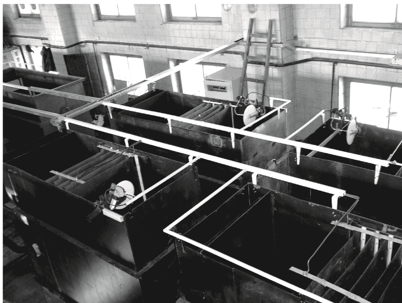
Рис. 2. Модульные установки электронейтрализационной очистки на Мурманской ТЭЦ
