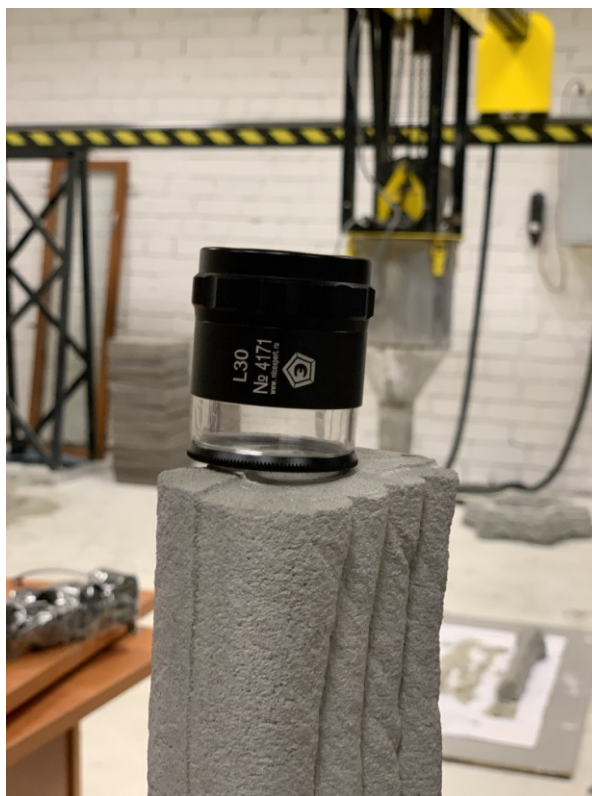
Рис. 1. Фиксация дефектов при помощи увеличительной лупы (иллюстрация авторов) Fig. 1. Fixing defects by means of a magnifying glass (illustration by the authors)
